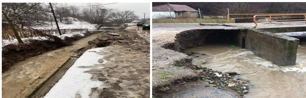
Fotografia 59. Dëmet e shkaktuara ne infrastrukturë rrugore
