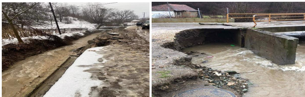
Fotografia 59. Dëmet e shkaktuara ne infrastrukturë rrugore
