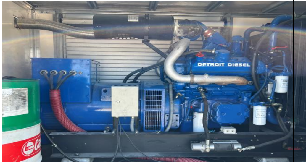
Fig. 3. Gjeneratori i Rrymës elektrike
