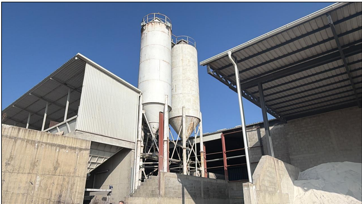
Figure 2. Siloset, të cilët janë 4 cope me kapacitet 100 ton
