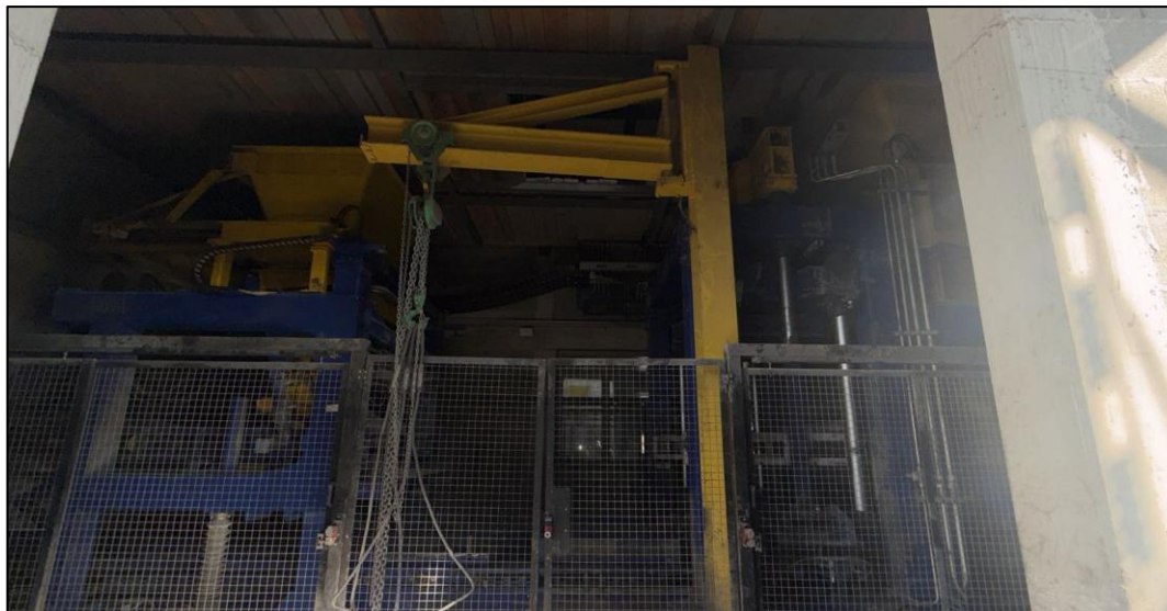
Figure 12. Makineria e prodhimit të kubezave dhe elementete nga betoni
