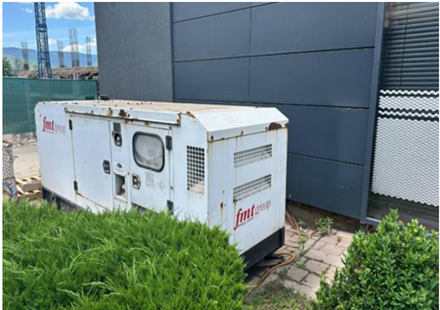
Figura 14. Gjeneratori i energjisë elektrike
