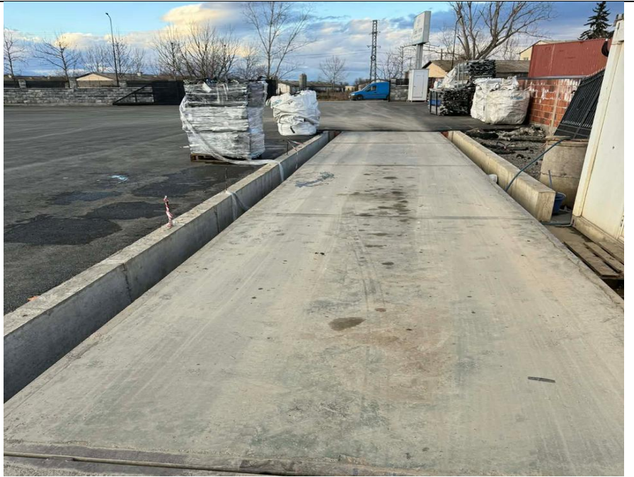
Peshore e madhe për matje të peshave të kamionëve
