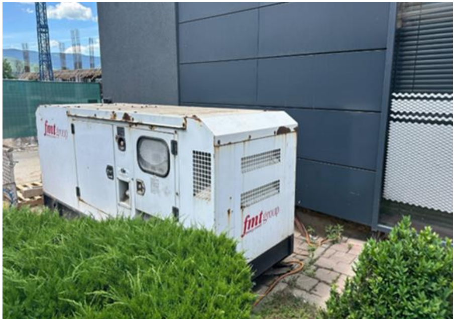
Figura 14. Gjeneratori i energjisë elektrike
