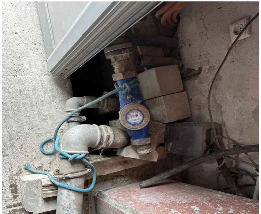
Figura 15. Baza për prodhimin e betonit "TREGTIA" Sh.P.K. Fushë Kosovë, furnizimi më ujë nga pusi
