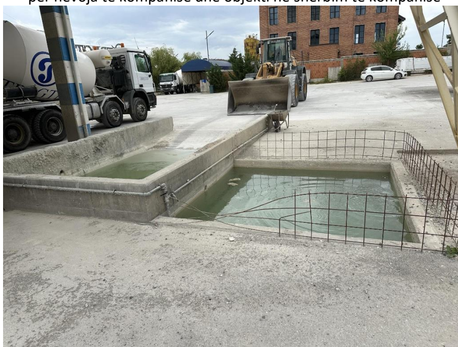
Figura 17. Baza për prodhimin e betonit "TREGTIA" Sh.P.K. Fushë Kosovë, basenet neutralizuese të ujërave të procesit
