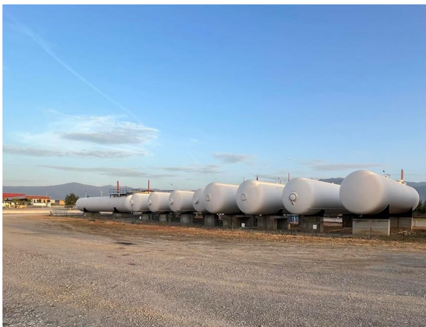
Foto 5. Disa prej rezervuarëve të gasit të vendosur në lokacion
