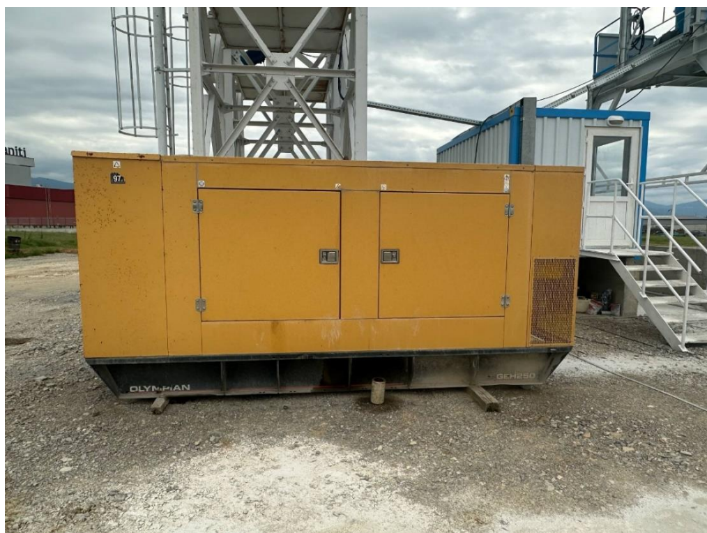
21. Gjeneratori i rrymës
