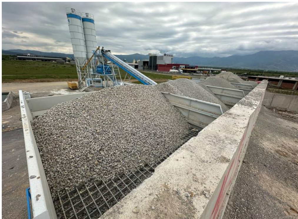
11. Bunkerët e agregatit, sipas fraksioneve
