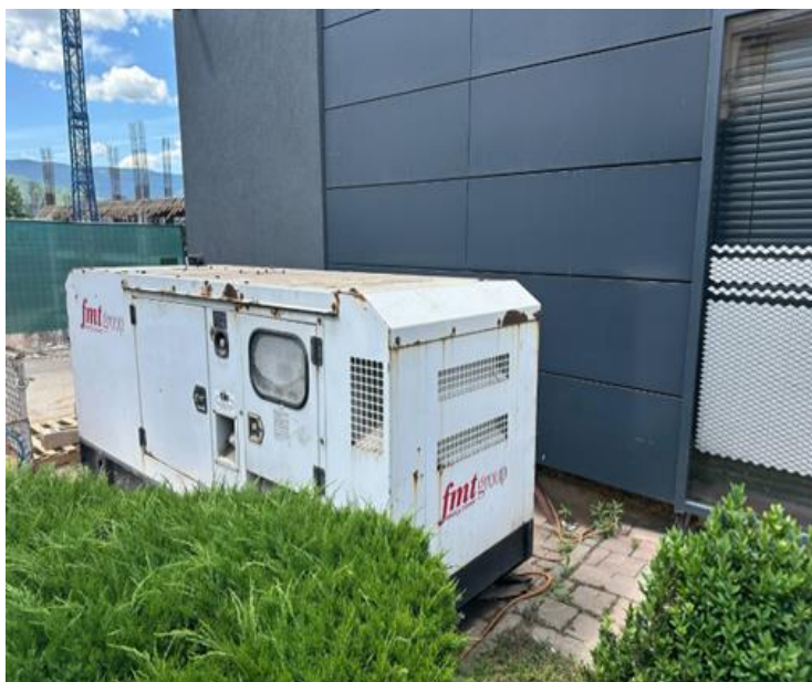
Figura 13. Gjeneratori i energjisë elektrike
