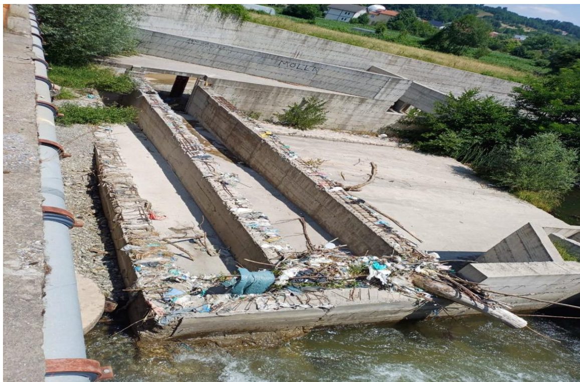
Foto 18. Bazat e betonit te cilat gjat rreshjeve te shumta shkaktojne vershime.
