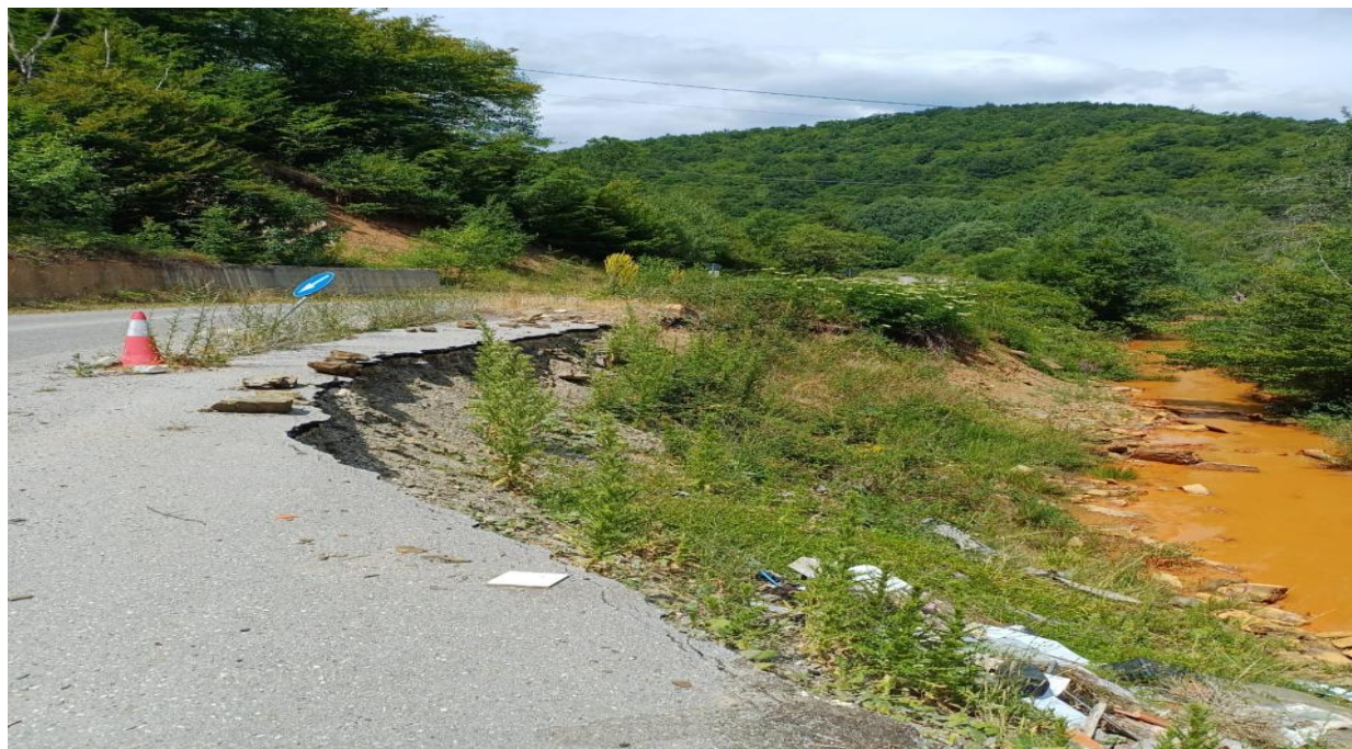
Foto 8 Lumi Morava e Binçës -Novobërdë - prishja e rrugës kryesore gjat vërshimeve, Novobërdë
