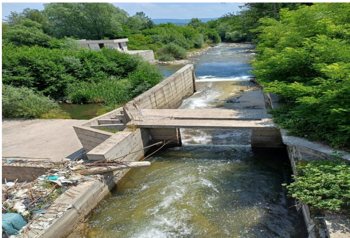
Foto 20. Pengesat e betonit te cilat pengojn rrjedhen e lumit Lepenc
