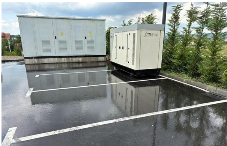
Figura 9. Trafo elektrike dhe gjeneratori
