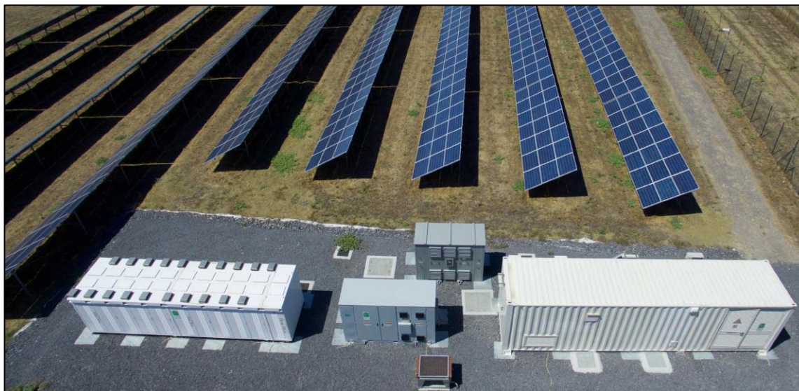
Figura 19. Sistemi i baterive BESS.
