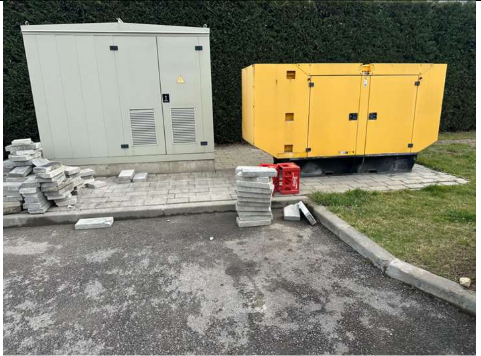
Figura 12. Trafo e rrymës dhe Gjeneratori
