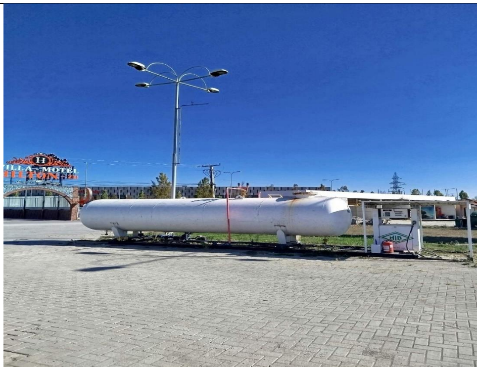
Foto HIB Petrol Llapllasellë, Graçanicë, rezervuari i gazit (propan - butan).
