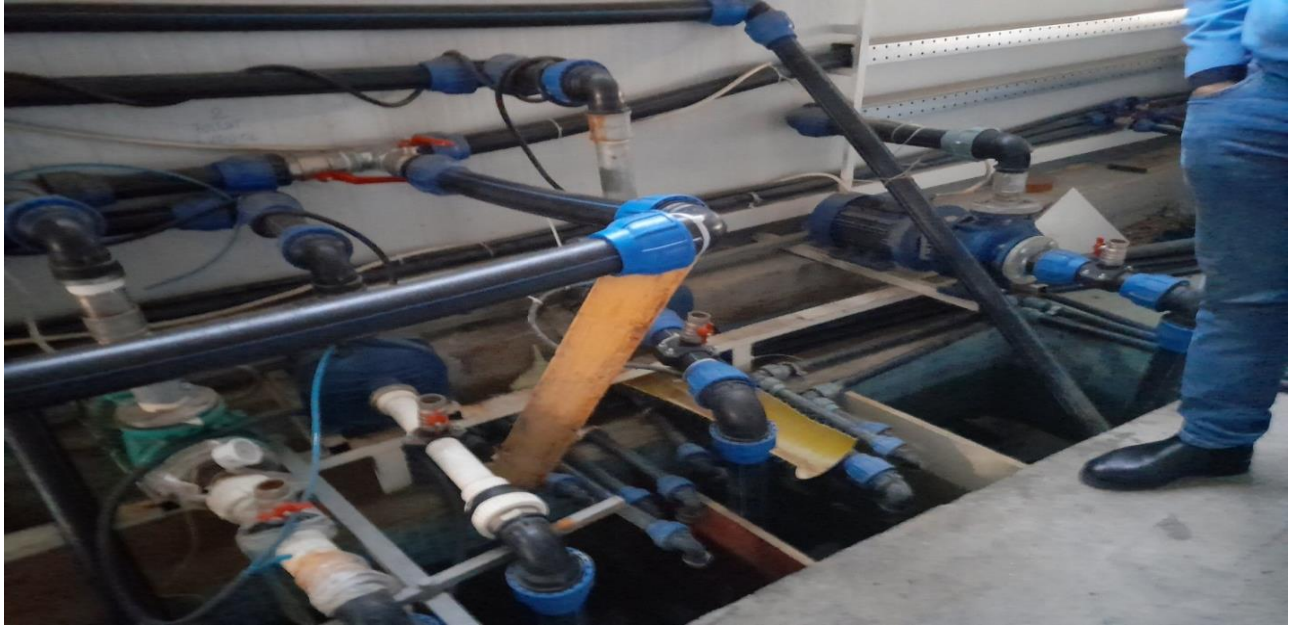
Foto 8. Pamja e gypave që kanë funksion systemin e ujit të mbyllur për ftohjen e paisjeve pa humbje apo pa shkarkimin e ujit , e që njikohesisht kalon edhe përmes frigoriferëve për ftohje efikase , pa shpenzimin e ujit.
