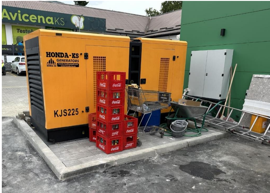
Figura 8. Gjeneratori i energjisë elektrike
