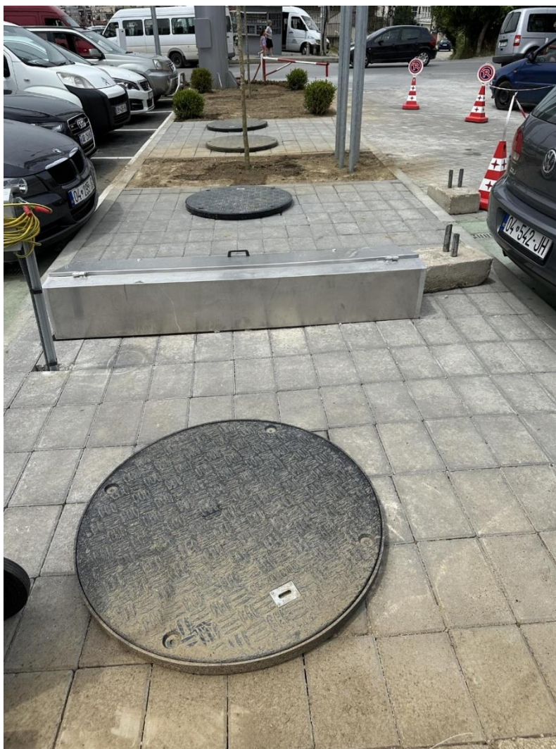
Figura 7. Rezervuarët e naftës dhe benzinës
