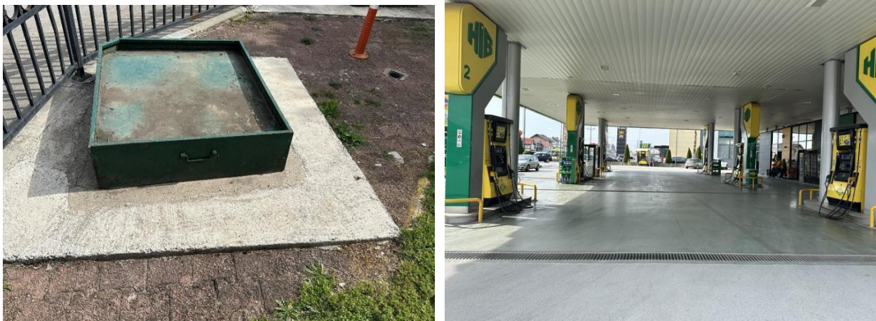
Fig. 8 & 9. Rezervuari i benzinës R 2 dhe pompat e benzinës dhe naftës
