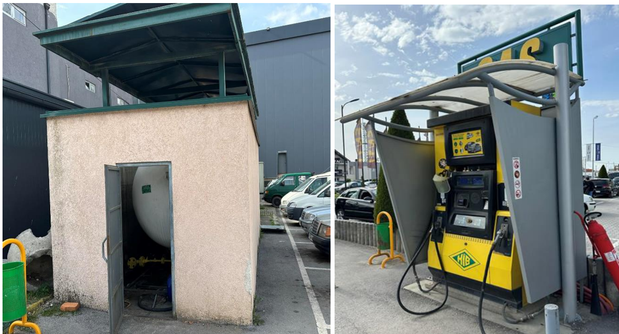
Figura 10 & 11. Rezervuar i gazit dhe pompa e gazit
