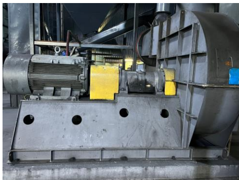
Foto 26 Ventilatori i mullirit
