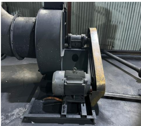
Foto 25 Ventilatori i Filtrit
